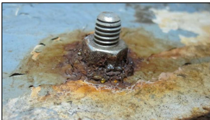
ภาพที่ 7.3 การกัดกร่อนต่างชนิด (Galvanic Corrosion)
